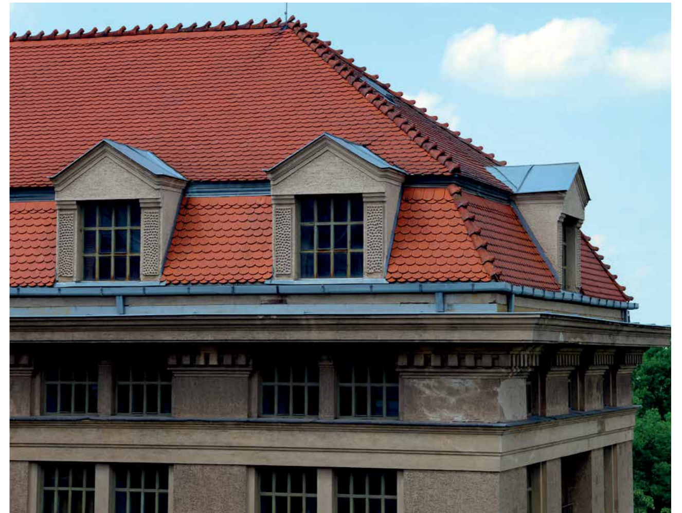
A Főépület esővíz elvezetéséhez használt csatornarendszer
